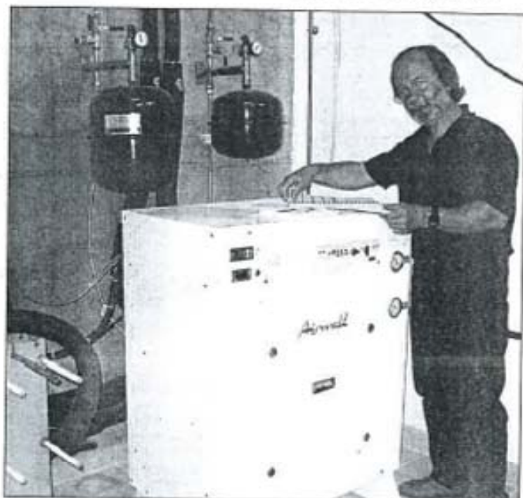
Manuel Ribeiro dans sa chaufferie : « C'est simple : la pompe à chaleur et l'échangeur font circuler l'eau chaude dans les planchers. »
